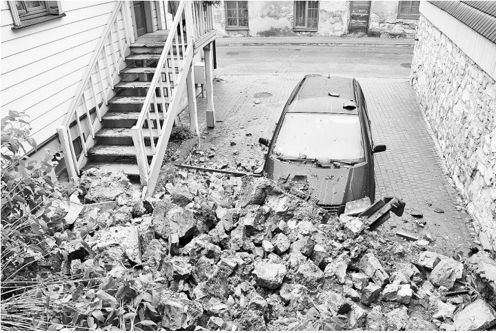
Attēlā: Palasta ielā lietus ūdeņu varenās straumes izskaloja mūra pamatus un tas nogruva, sabojājot arī automašīnu. Foto: Aleksandrs Abramovs.
