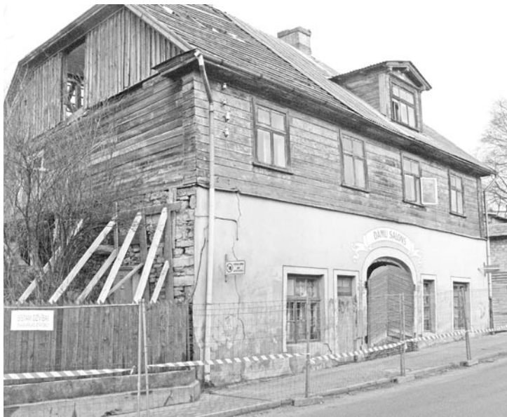
Attēlā: Bīstamā “Dāmu salona” ēka ir norobežota un sāktā jumta demontāža. Objekta novākšanu organizē pašvaldība, bet izdevumi būs jāsedz ēkas īpašniekiem.
